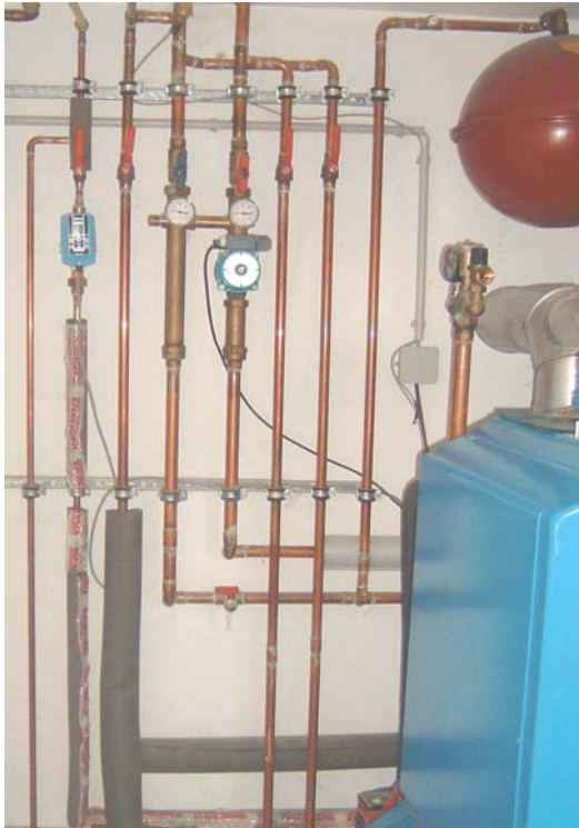
Bild 2a: Rohrleitungen ungedämmt bzw. ungenügend gedämmt - Hoher Energieverbrauch
