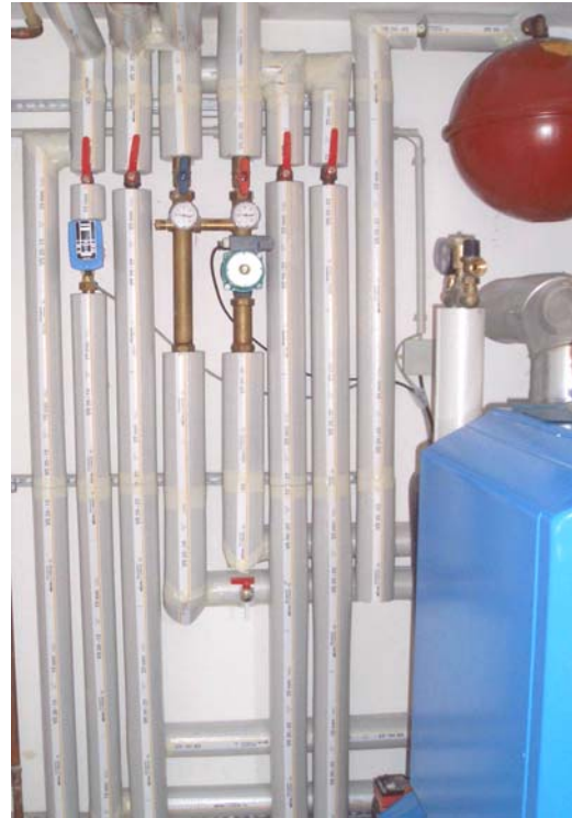
Bild 2b: Rohrleitungen nachträglich gedämmt - deutlich geringerer Energieverbrauch
